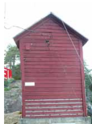
Det verna kabelhuset på Einersneset på Sand.
